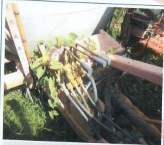
Vista Lateral (Llaves y Valvulas de Control)
